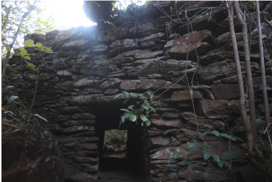
Figura 3: Galeria pluvial na Trilha da Estrada Imperial
