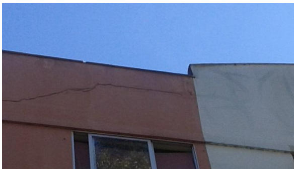
Figura 6 - Dilatação e expansão da laje de cobertura Fonte: Oliveira (2016)
