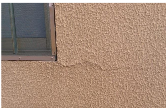
Figura 10 - Ausência de contra-verga Fonte: Oliveira (2016)
