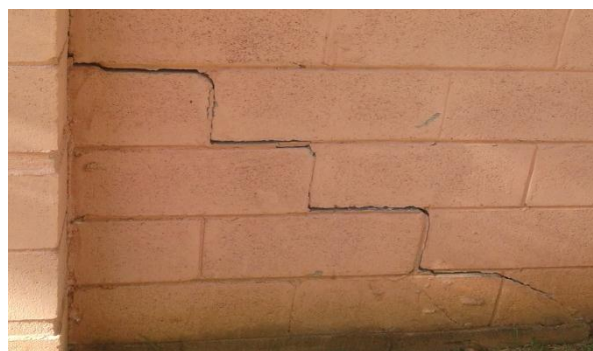
Figura 9 - Esmagamento da argamassa de assentamento Fonte: Oliveira (2016)
