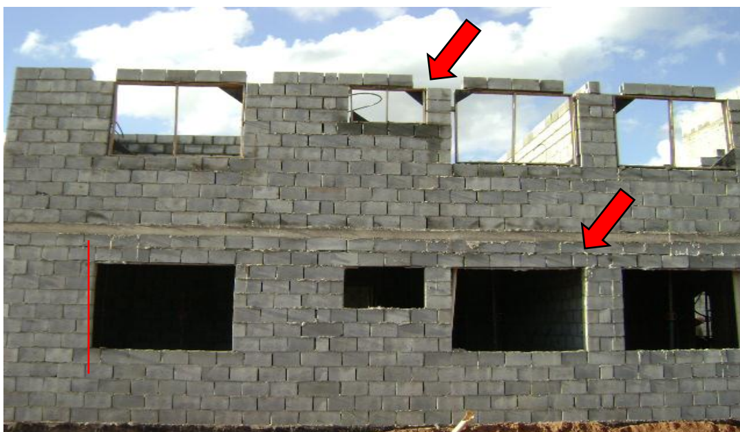
Figura 1- Fachada comprometida por falhas de execução Fonte: Autores, 2016
