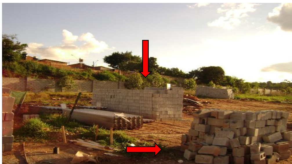
Figura 3 – Armazenamento incorreto de materiais Fonte: Autores, 2016
