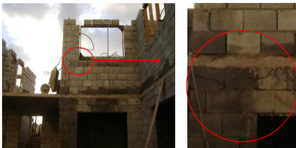
Figura 5 – Fissuras devido ausência de verga Fonte: Autores, 2016
