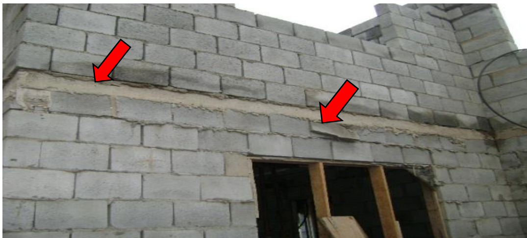
Figura 2 - Fachada comprometida com blocos soltos e juntas mal executadas Fonte: Autores, 2016
