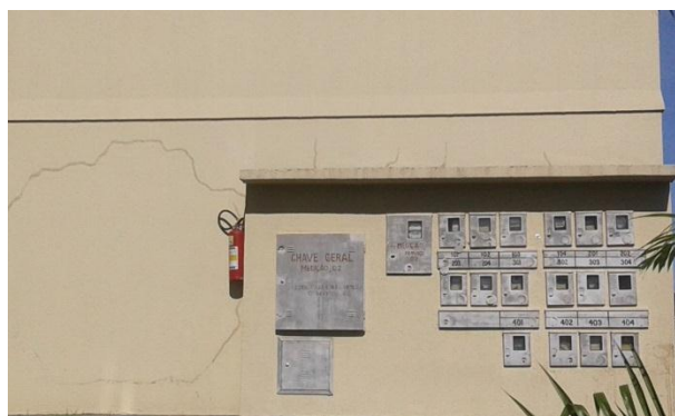
Figura 11 - Falta de reforço na mudança de espessura Fonte: Oliveira (2016)
