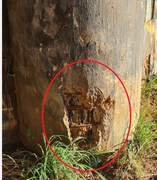
Figura 9 - Desagregação do concreto em pilar do viaduto Ayrton Senna. Fonte: Autores.
