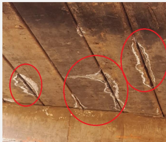
Figura 8 - Manchas de eflorescência no viaduto da BR-153. Fonte: Autores.
