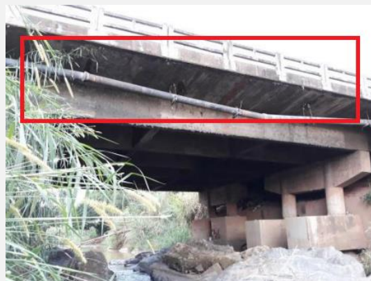
Figura 7 – Manchas de umidade na ponte da Avenida Ana Jacinta. Fonte: Autores.
