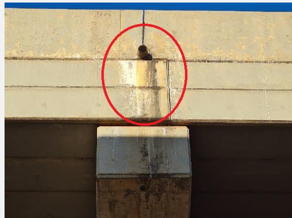
Figura 6 - Tubo de drenagem lançando água diretamente no pilar. Fonte: Autores.
