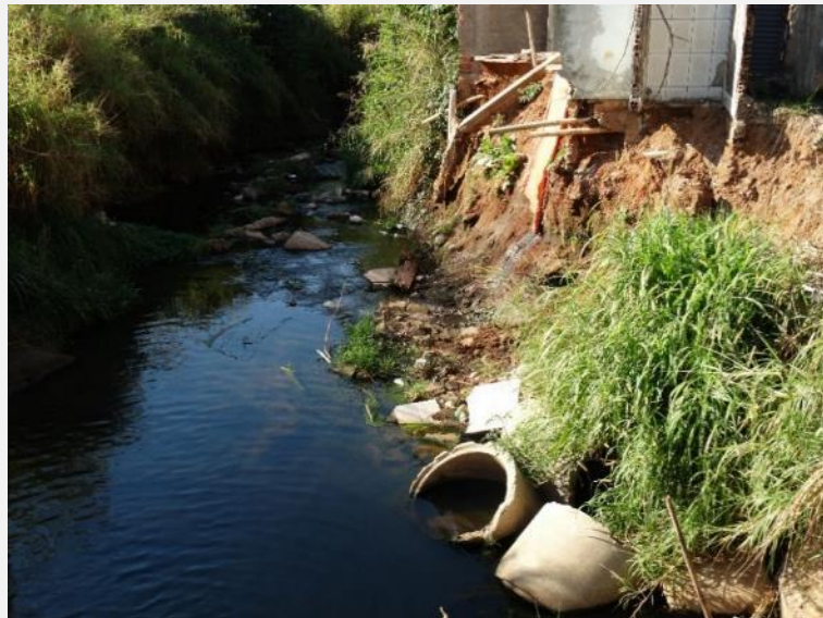
Figura 9 – Ocupação irregular da margem do Córrego Água Fria no Bairro Santa Maria de Nazareth. Fonte: Autores, 2017.
