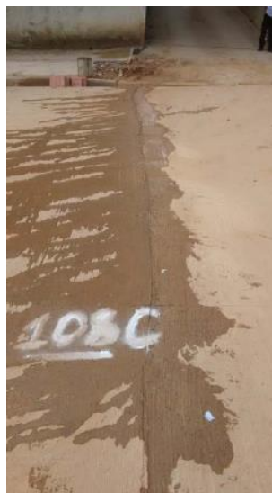
Figura 8. Junta de construção com provável movimentação de fôrma. Fonte: Autores, 2020.
