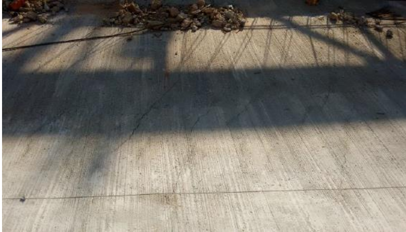
Figura 4. Fissuras lineares por acomodação do concreto. Fonte: Autores, 2020.
