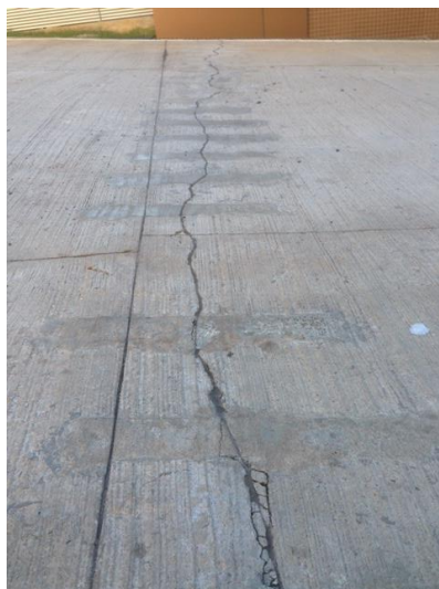
Figura 22. Estado do reparo de inserção de barras lisas (CA25). Fonte: Autores, 2020.
