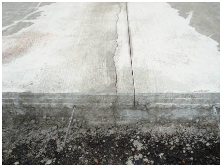
Figura 1. Surgimento de fissura devido ao atraso de corte. Fonte: Autores, 2020.
